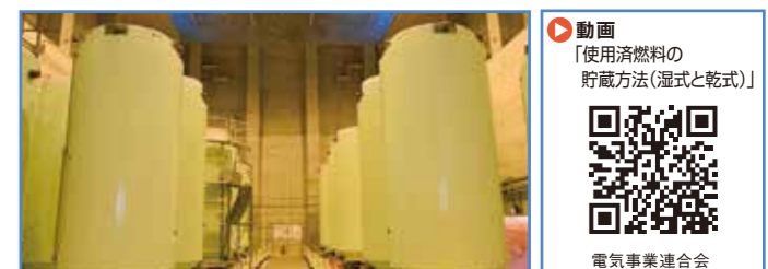
東海第二発電所使用済燃料乾式貯蔵施設（茨城県東海村） 写真提供：日本原子力発電（株）
