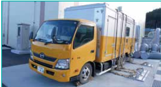
電源車 写真提供:東北電力(株)
