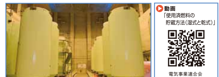
東海第二発電所使用済燃料乾式貯蔵施設(茨城県東海村) 写真提供:日本原子力発電(株)
