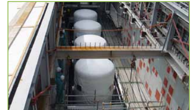
フィルタ・ベント 写真提供:中国電力(株)
