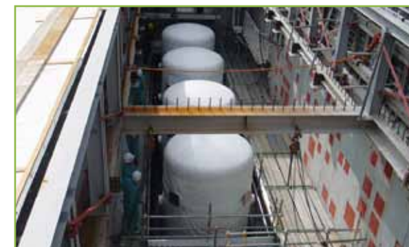
フィルタ・ベント 写真提供:中国電力(株)
